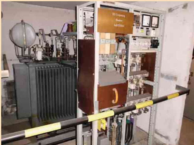
2 Alte Trafostation mit ISA-2000-EV-Anlage – Altanlage mit höheren Risiken
