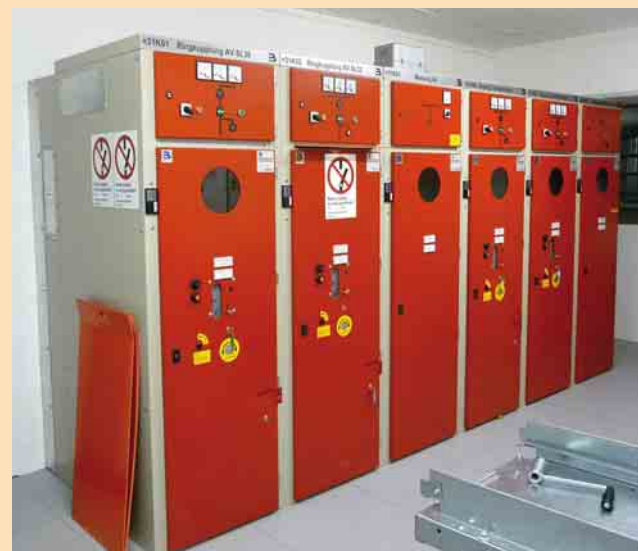
1 Neue Trafostation der Berliner Charité – MS-Anlage mit Druckreduktionssystem
