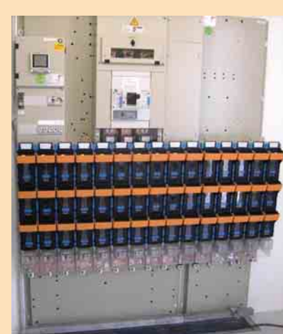
3 Neue Trafostation mit NS-Verteilung – stahlblechgekapselte Einspeisung
